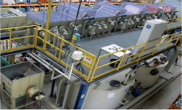
Pilotanlage zur Entzinkung im Technikum des CUTEC
