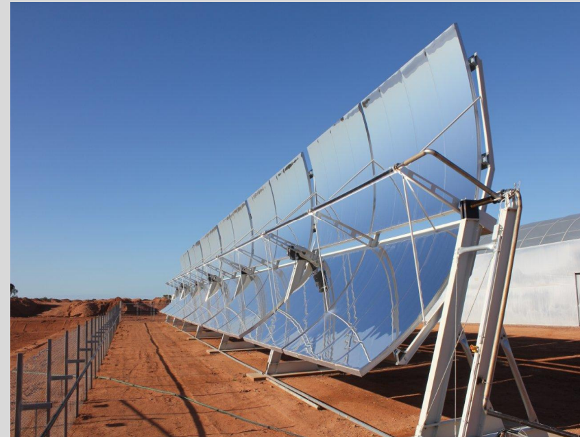
CSP – Anlage in Porta Augusta, Australien
